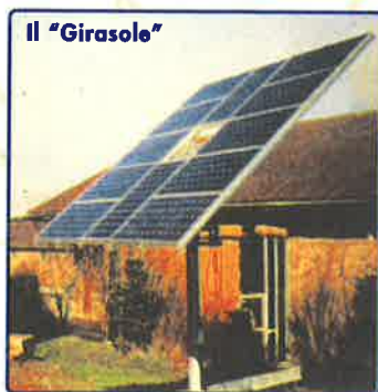
Sistemi Fotovoltaici ad inseguimento solare
